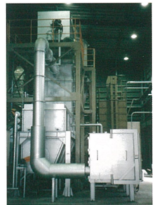
高水分原料炭化プラント
