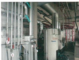
温水に変換し、床暖房
