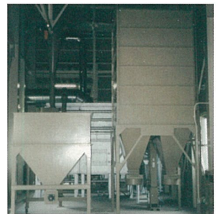
製品貯留タンク
