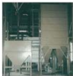
製品貯留タンク
