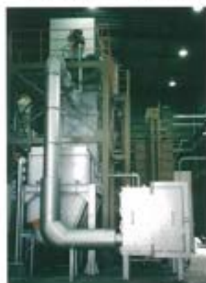
高水分原料炭化プラント
