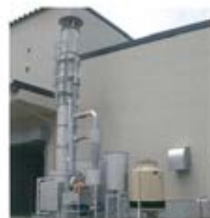
乾式煙突集塵機
